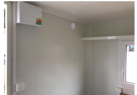
Sicherungskasten rechts neben Türe
