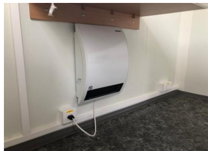
Elektroheizung unter Tisch
