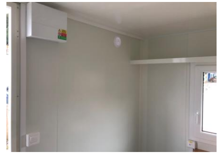
Sicherungskasten rechts neben Türe
