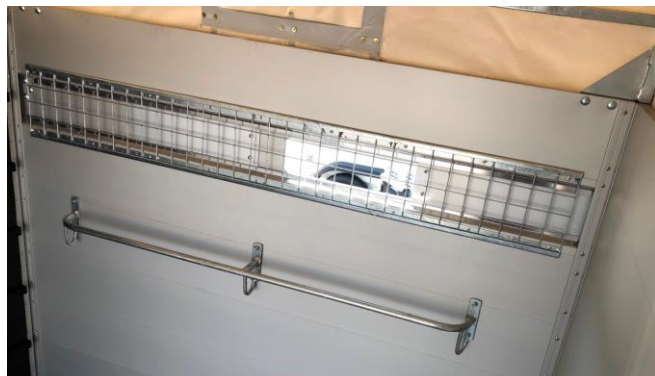
Lüftungsgitter in Stinwand, Innenansicht
