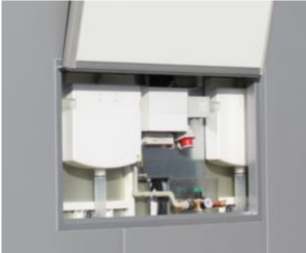
Service-Klappe an Rückseite
