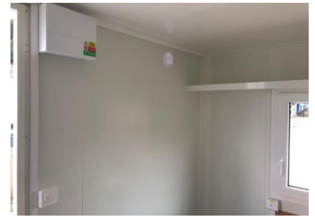
Sicherungskasten rechts neben Türe
