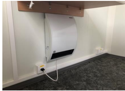
Elektroheizung unter Tisch
